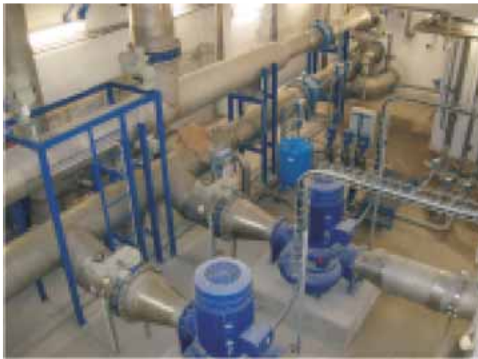
Technologické vstrojení akumulace
