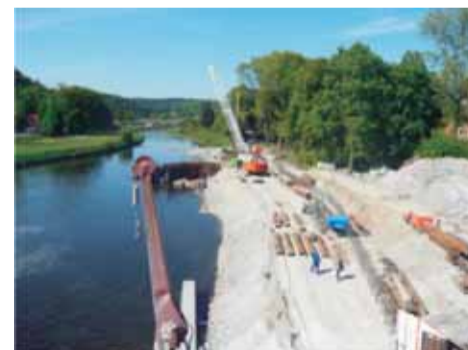
Štěťová jímka – dolní voda
