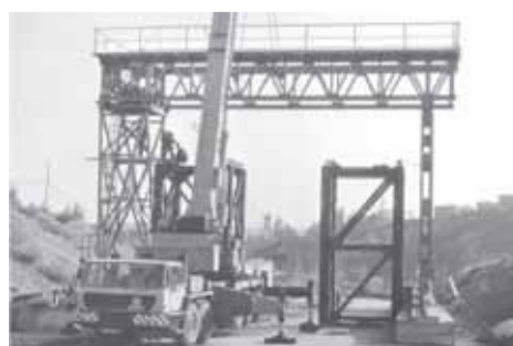
Montáž portálového jeřábu o nosnosti 60 t vyrobeného ve VOK Beroun na stavbě
