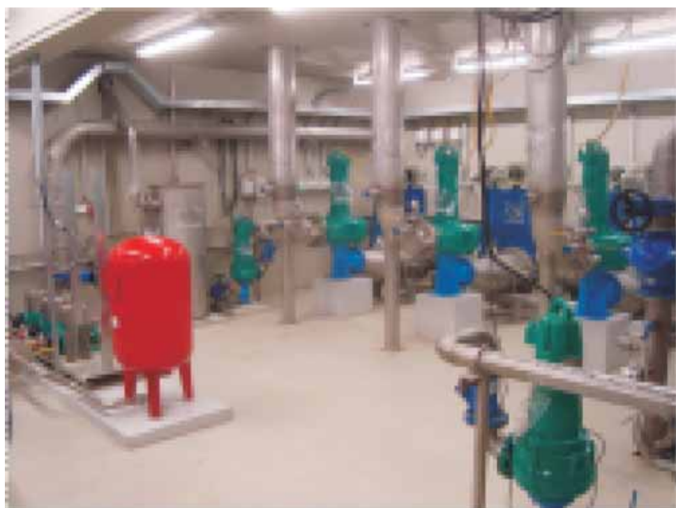
ČOV Cheb – čerpací stanice vratného kalu 2PP vybavena technologií
