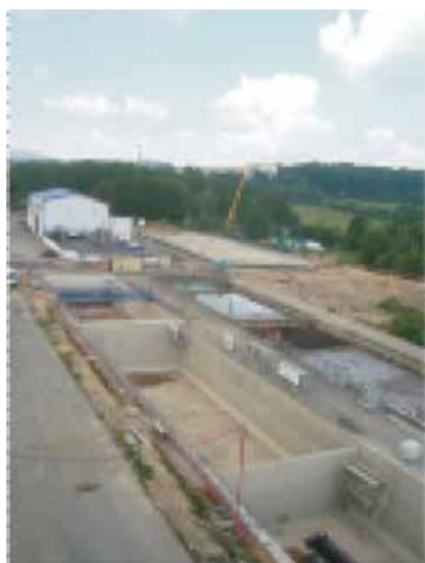
ČOV Cheb – část biologických linek, hala hrubého předčištění, dešťová zdrž v pravém horním rohu
